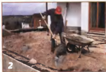
2 В качестве фундаментных опор использованы закопанные в грунт и забетонированные асбоцементные трубы \varnothing 400 мм.
